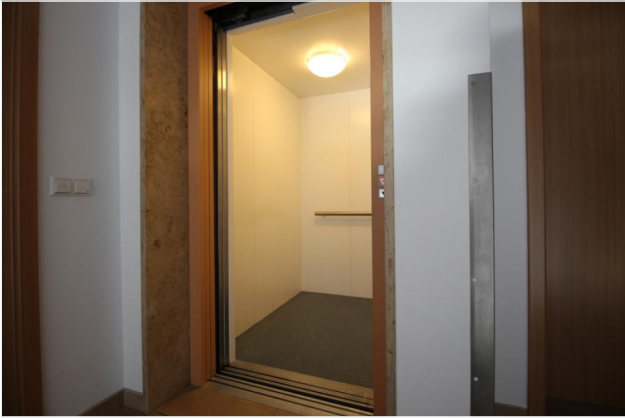
Aufzug bis vor die Wohnungseingangstüre
